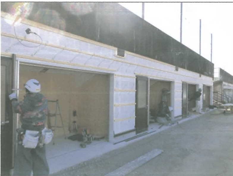
球場トイレ倉庫化
