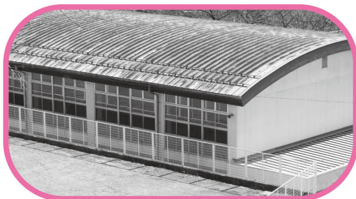
老朽が進む北小体育館の屋根
