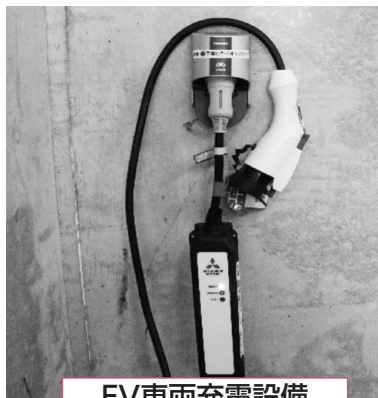
EV車両充電設備
