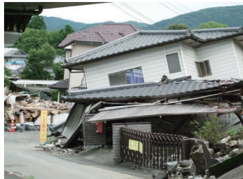
【熊本地震被害状況】
