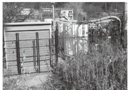
高浜源湯配湯場
