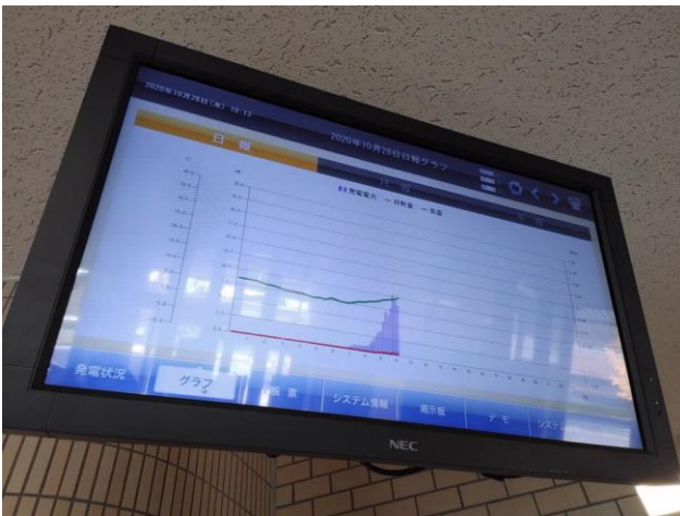
役場屋上に設置されている太陽光パネルの発電の監視
