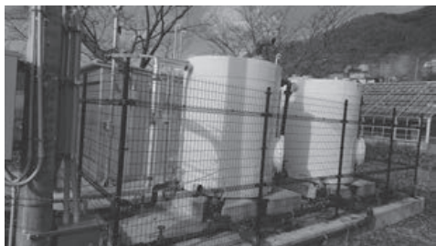
高木源湯の配湯設備
