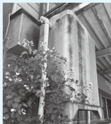
39年間使用している家庭用温泉タンク
