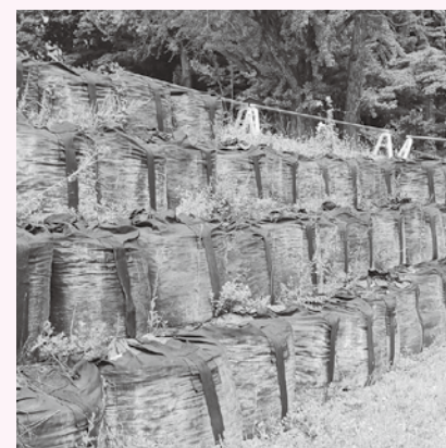
山王閣跡地の斜面の劣化が進む
