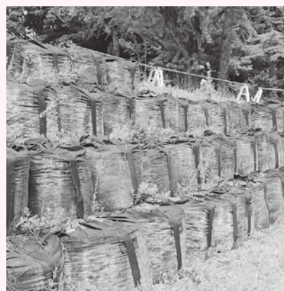
山王閣跡地の斜面の劣化が進む
