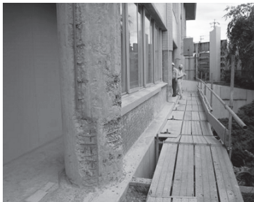
打設不良のみつかった庁舎柱
