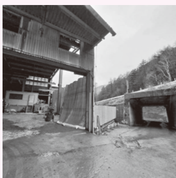
142号線事故現場
