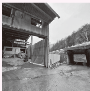
142号線事故現場
