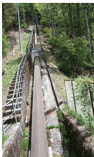
蝶ヶ沢発電所の導水管
